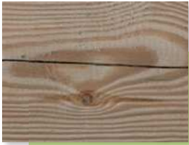
Spannungsrisse durch die Holztrocknung
